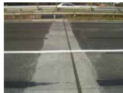
《ジョイント部の損傷》
