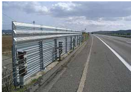
《防雪柵設置状況》東北道 二本松IC～福島西IC間
