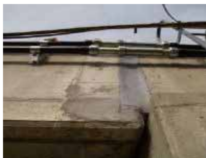
《橋梁壁高欄 Co 剥離》
