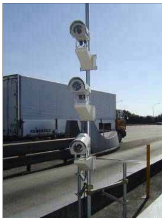
(不正通行対策用監視カメラ)
