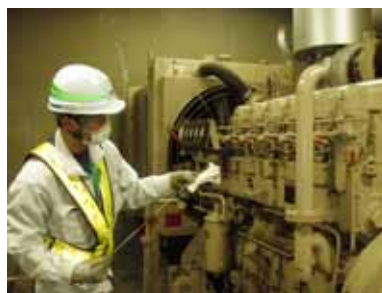
(自家発電設備の点検) 関越自動車道 所沢IC
